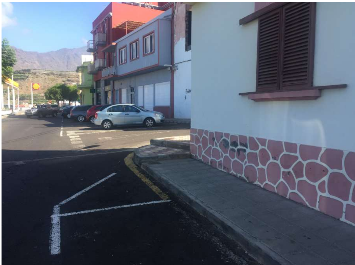
Desniveles en zonas de circulación peatonal. Encuentre Avda. de la Constitución con Calle Progreso
